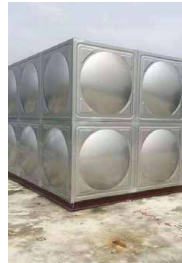
再生水高位水箱
